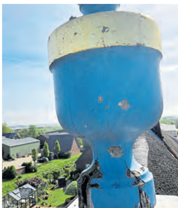
Stark beschädigte Oberfläche
